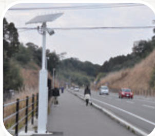
防犯灯の設置・電球交換、電気代の支払い
